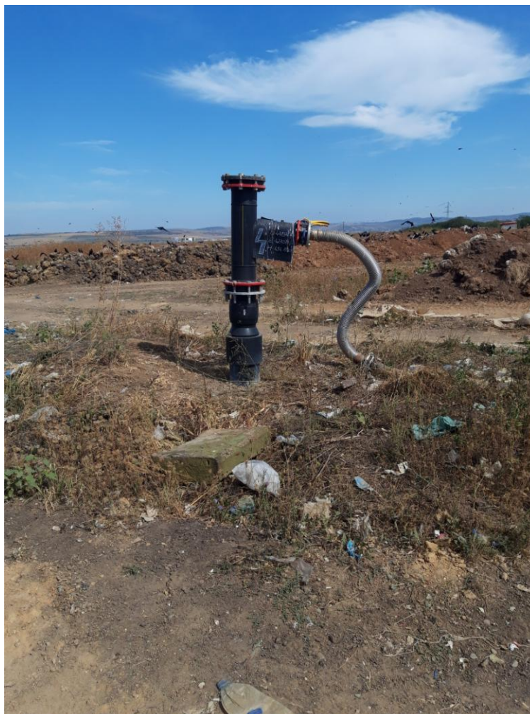
Figura 3 – Capul special de puț de gaz, record flexibil inox și conducta transportoare
