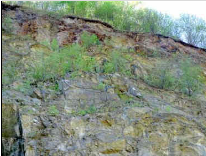
Figura nr. 20 – Aspect privind instalarea pe cale naturală a vegetației lemnoase pe pereții vechii cariere închise, învecinate cu perimetrul analizat (se constată prezența speciei pioniere Betula pendula (mesteacăn))
