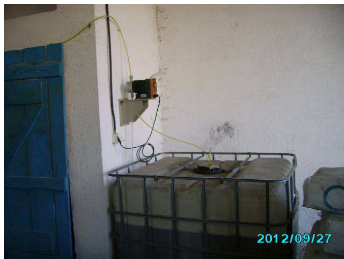
Fig. 4.7 Pompa dozatoare floclulant
